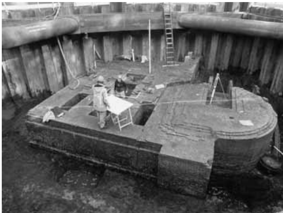
Afb. 56. Rotterdam* Statenweg (Blijdorp). Het vrijgelegde fundament van het stoomgemaal van Blijdorp aan de huidige Statenweg.
