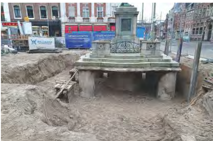
Bouwput voor de werkzaamheden aan het standbeeld van Johan de Witt. (Foto: Afdeling Archeologie, Gemeente Den Haag)
