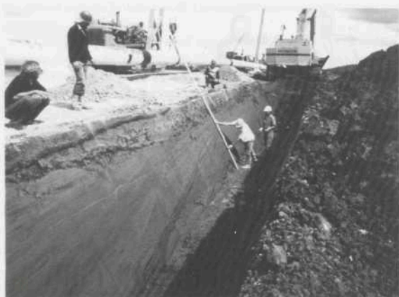
Afb. 9. Beverwijk-Oudelandertocht: pijpleiding. Werkzaamheden in de leidingsleuf, met op de voorgrond de rand van een Calais-geul (Wieringermeerpolder). Foto ROB.
