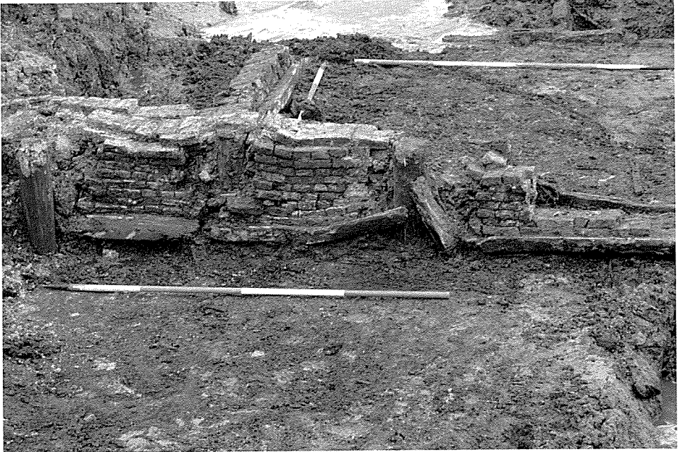
Afb. 10. Amsterdam * Haarlemmerplein 14-16. Het muurwerk van pand nr. 16 is met het onderliggende langshout over de palen heen gezakt (foto: bureau Monumenten en Archeologie, W. Krook).
