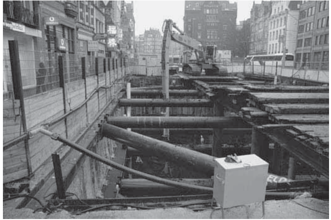
Afb. 9. Amsterdam * Noord/Zuidlijn. De ontgraving van het westelijk deel van de noordelijke verdeelhal Rokin (foto: Bureau Monumenten en Archeologie, R. Jayasena).
